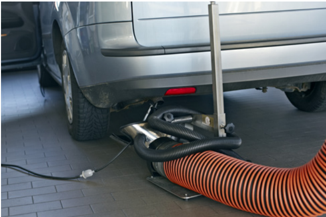
Abb. 17-1 Abgasabsaugung mit oberirdischer Anlage
